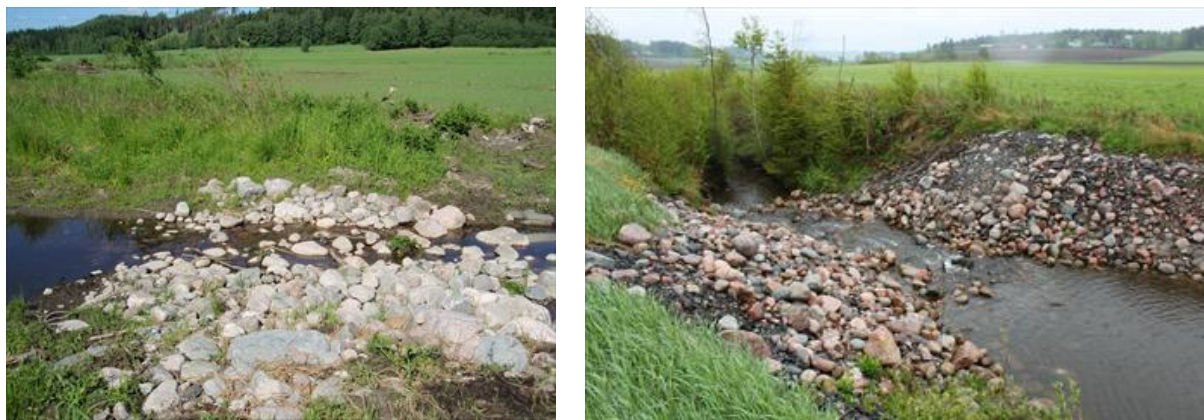
Kuva 5. Esimerkkejä rakennetuista pohjapadoista. (ymparisto.fi)
